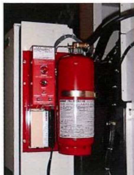
自動消火装置
